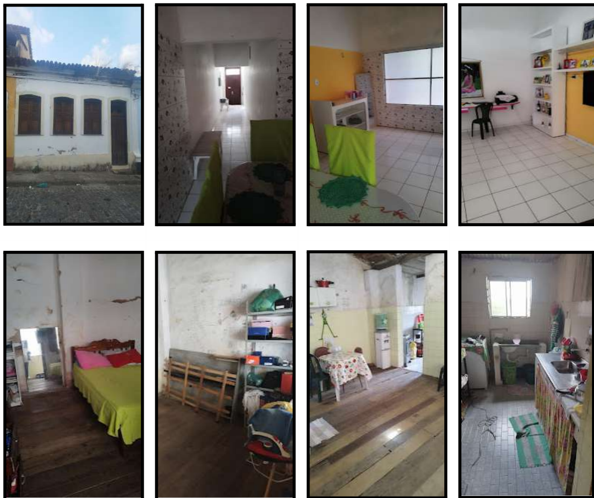
Imagem 30 - Fachada e comparativo entre as partes reformada e não reformada da casa do Seu Nezinho
