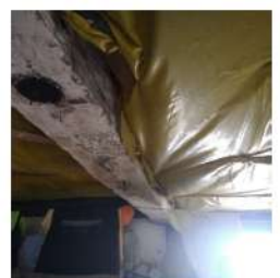
Teto do local precisando de reparos.
