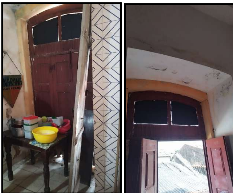
Imagem 35 - Paredes de um dos seus apartamentos com infiltrações
