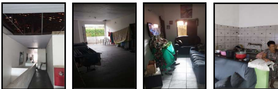
Imagem 43 - Problemas de conservação do Edifício Humberto de Campos depois da reforma
