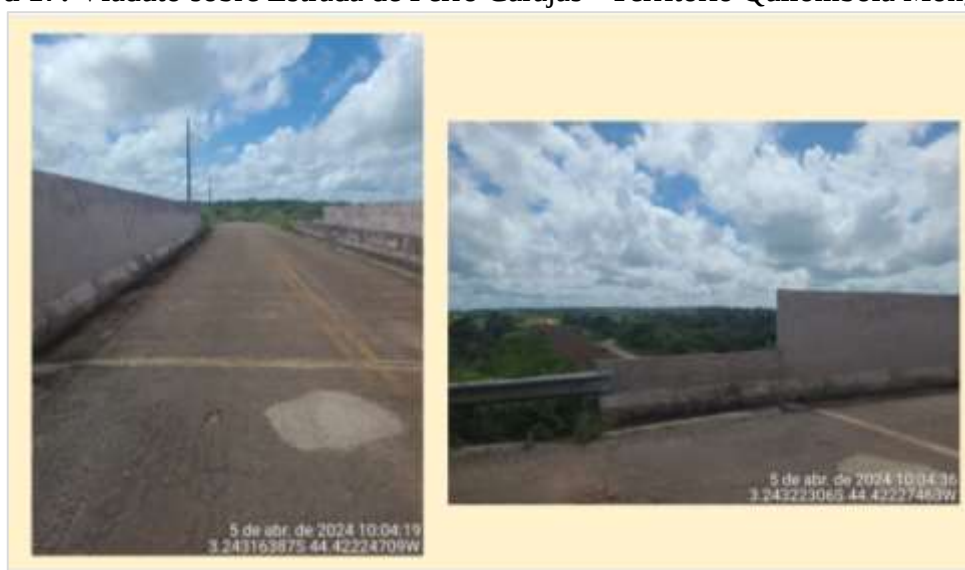
Figura 17: Viaduto sobre Estrada de Ferro Carajás - Território Quilombola Monge Belo
