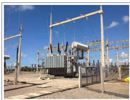
(a) Imagem real da subestação
