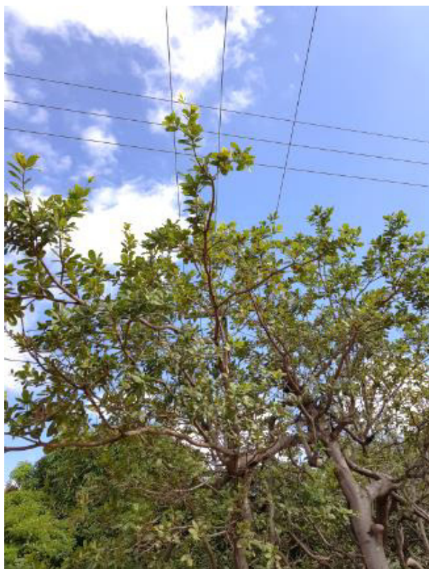
Figura 37 - Cajueiro localizado abaixo de uma RD cujo tipo de serviço necessário é o AMR
