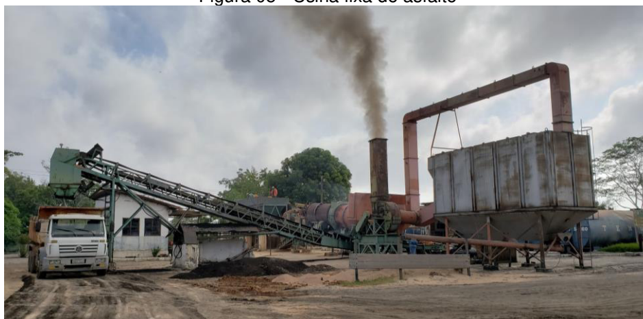
Figura 05 - Usina fixa de asfalto
