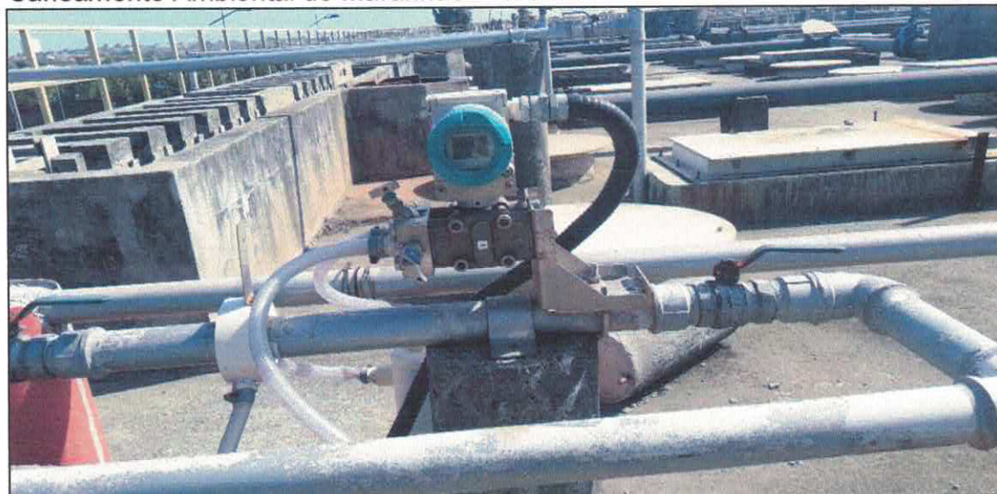
Figura 6 – Medidor de biogás instalado na saída do sistema de coleta dos reatores (RAFA), da estação de tratamento de esgotos – ETE do Vinhais – Companhia de Saneamento Ambiental do Maranhão – CAEMA
