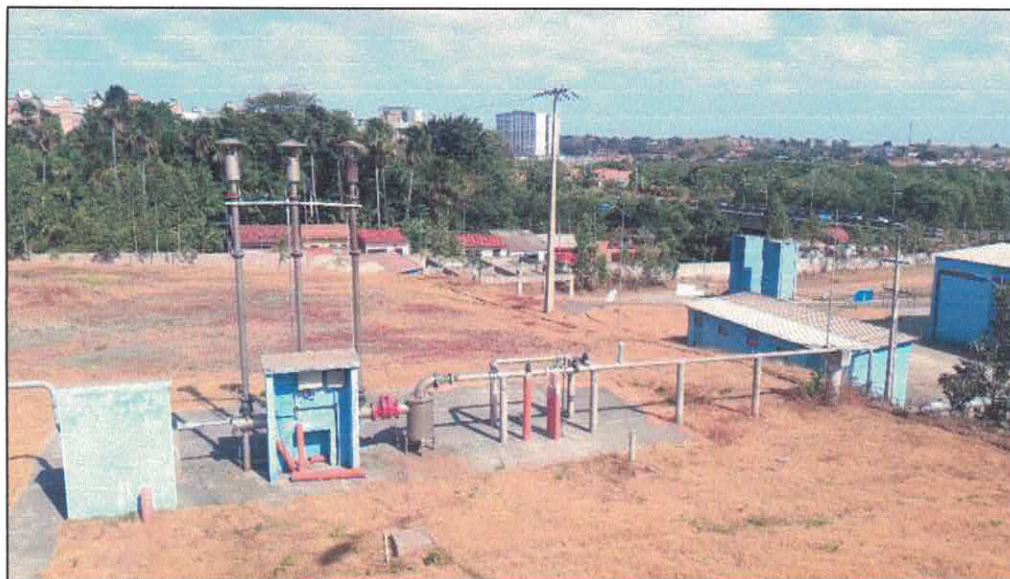
Figura 5 – Queimadores de biogás instalados nas tubulações do sistema de coleta dos reatores (RAFA) da estação de tratamento de esgotos – ETE do Vinhais – Companhia de Saneamento Ambiental do Maranhão – CAEMA
