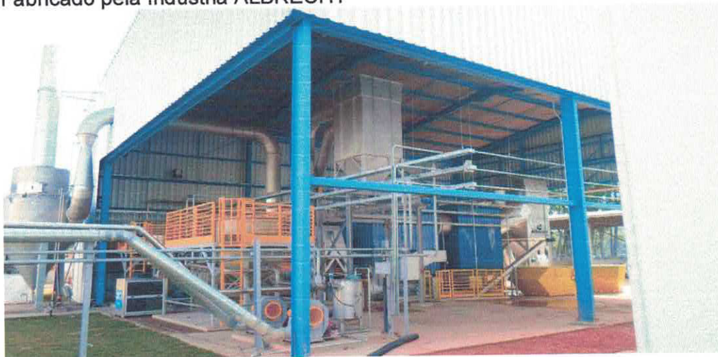
Figura 8 – Sistema de Tratamento do Biogás, com filtração e compressão, contendo unidade de condensação, dessulfurização, remoção de siloxanos e resfriamento. Fabricado pela Indústria ALBRECHT
