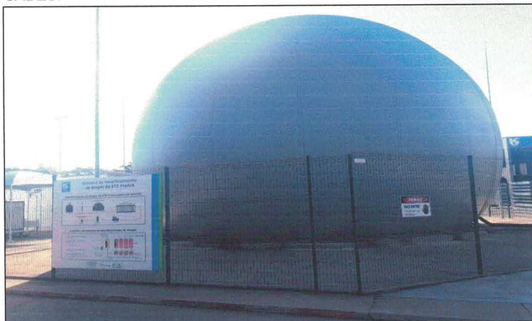
Figura 4 – Gasômetro do sistema de beneficiamento de biogás da ETE de Franca SP, SABESP
