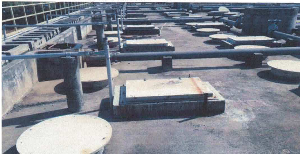
Figura 7 – Sistema de coleta de biogás dos reatores anaeróbios de fluxo ascendente (RAFA) da estação de tratamento de esgotos – ETE do Vinhais – Companhia de Saneamento Ambiental do Maranhão – CAEMA
