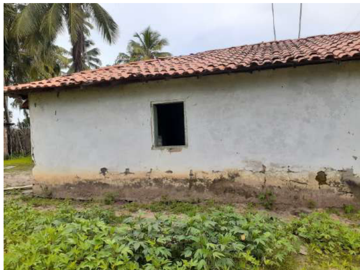
Figura 40 – Umidade e trincas na casa do Sr. Lorenzo Boaventura Ferreira (Digé) – Vista externa
