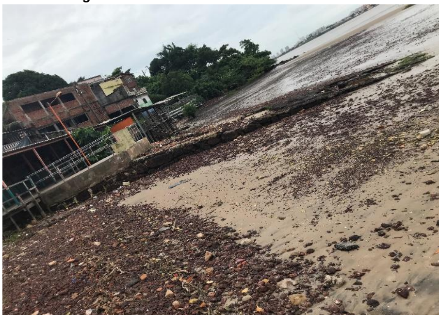
Figura 18 - Ruínas da escadaria do Cais do Bonfim.
