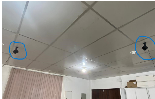
Figura 6.9: Posicionamento do Lighthouse VR no teto. Fonte: Autor
