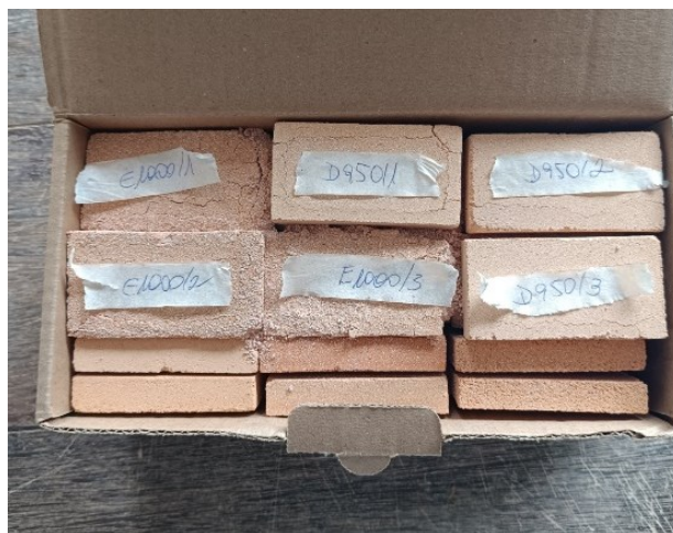
Figura 35 - Peças armazenadas se desmanchando
