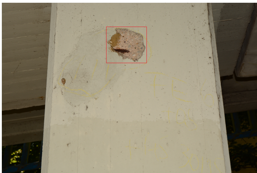
Figura 3 – Fragmentação de parte do concreto. Adaptado de (CODEBRIM 2019).
