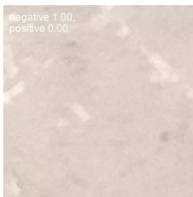
Figura 28 – Classificação negativa para fissura. Elaborada pelo autor.
