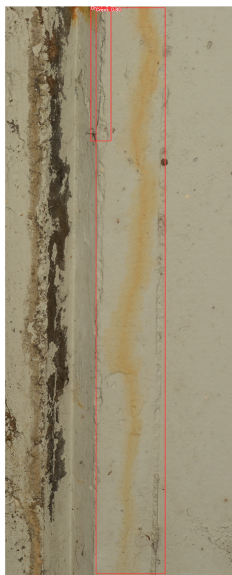
(A) Mancha de Corrosão
