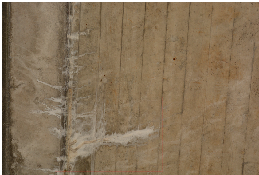
Figura 4 – Eflorescência na superfície do concreto. Adaptado de (CODEBRIM 2019).
