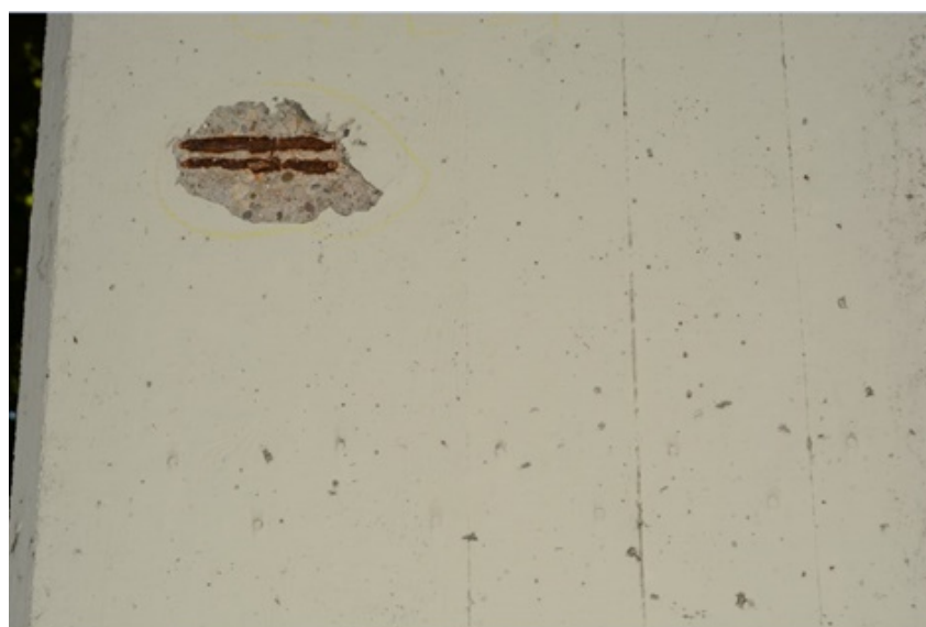
Figura 30 – Imagem de patologias no concreto antes da detecção com YOLO ( CODEBRIM 2019 ). Elaborada pelo autor.
