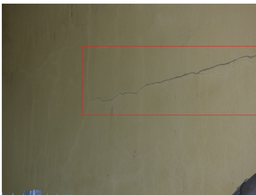
Figura 1 – Fissura/Rachadura. Adaptado de (CODEBRIM 2019).
