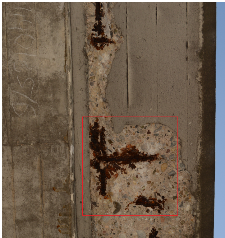
Figura 2 – Barra de aço exposta. Adaptado de (CODEBRIM 2019).
