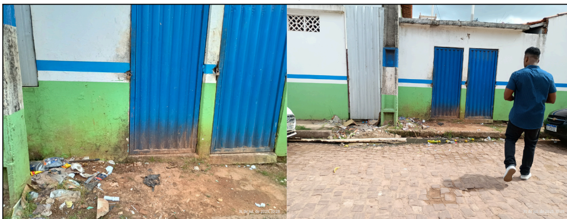
Figura 72 - Registro da fachada da lixeira da Maternidade Dom Hélio Campos, Viana-MA, 2025.
